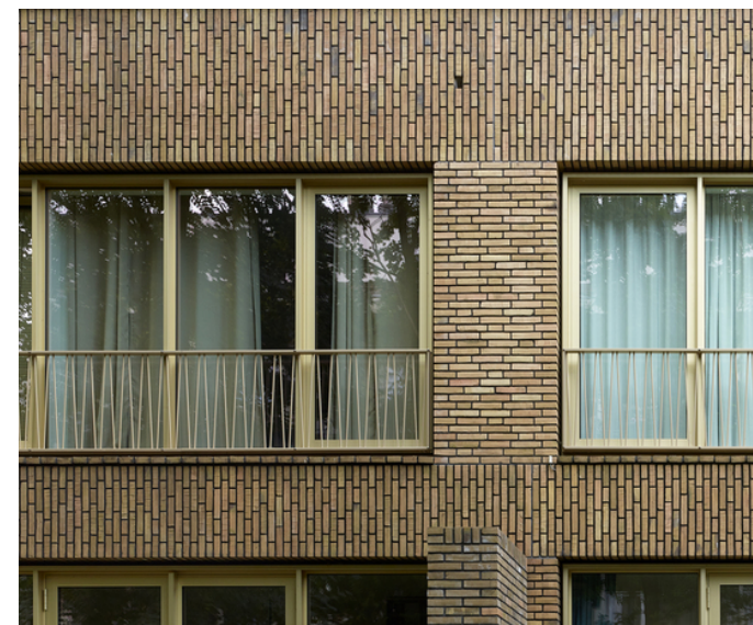
Kozijnen liggen niet vlak in de gevel.
